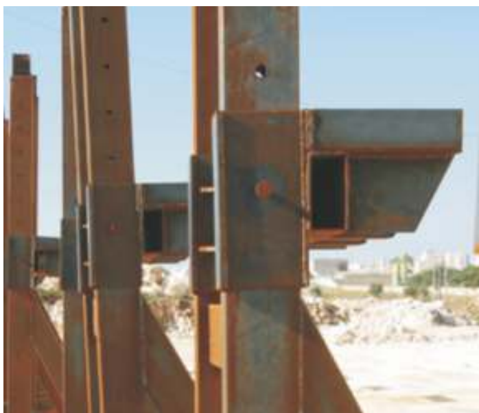
Prima del trattamento il metallo mostra evidenti segni di corrosione
